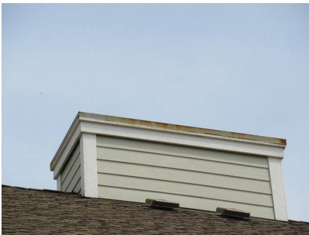
Chimney cap rust
