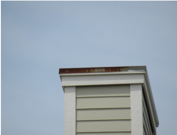
Chimney cap rust
