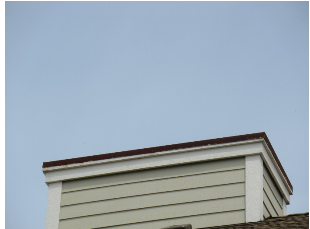
Chimney cap rust
